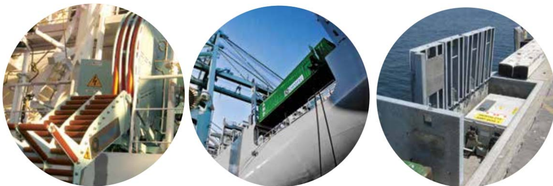
Figure 25 Enrouleur de câbles sur le pont du navire. Conteneur avec enrouleur de câbles. Caniveau avec connecteurs de raccordement
