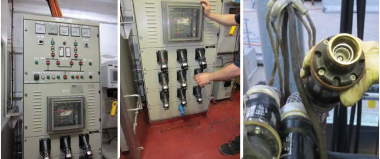
Figure 6 Panneau de connexion et de commande et détail de la fiche d'un câble
